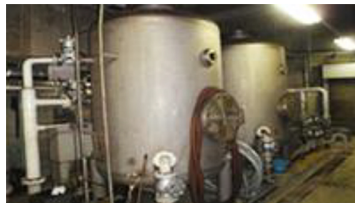
中水利用の事例：新宿フントンホテル本館のろ過施設
