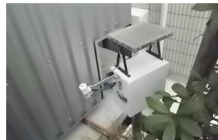
節水設備の事例：Luz自由が丘の灌水設備
