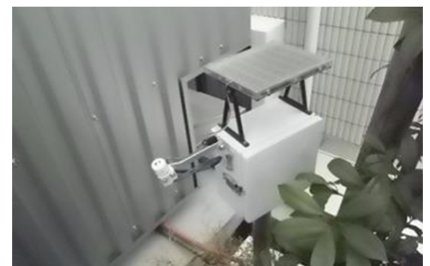
節水設備の事例：Luz自由が丘の漏水設備
