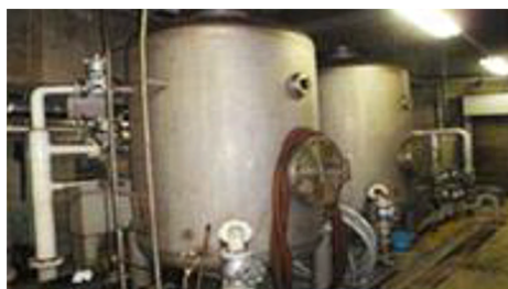
中水利用の事例：新宿ワシントンホテル本館のろ過施設
